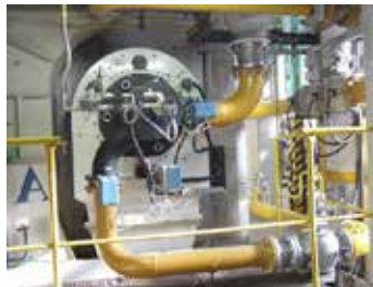
Figure II.10.23: Sugar factory heater operated with biogas and natural gas (Source: Magyar Cukor Zrt, Biogáz Fejlesztő Kft., 2014)
